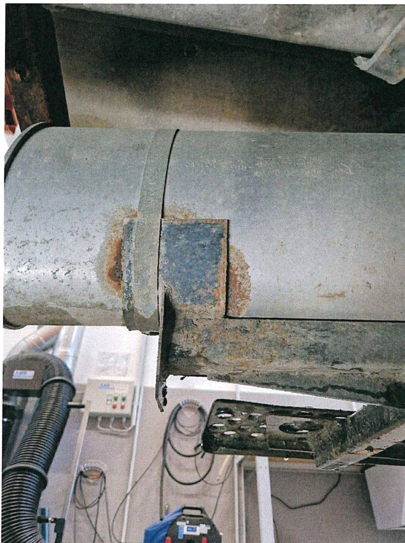
Bild 16 : Schalldämpfer stark korrodiert
